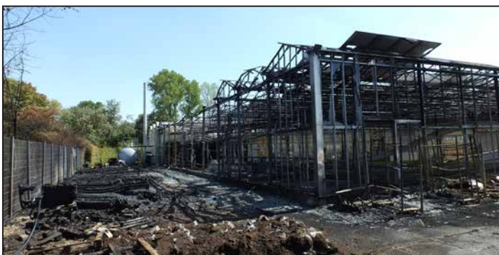
Photo 4 : serre Venlo totalement sinistrée suite à un feu de talus.
