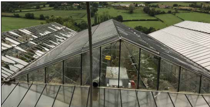
Photo 3 : le côté exposé à la grêle et au vent a été totalement détruit alors que l'autre côté est resté presque intact.
