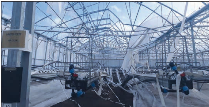
Photo 2 : en plus des films, la structure d'une chapelle de cette serre de production de fraises a subi de lourds dommages.
