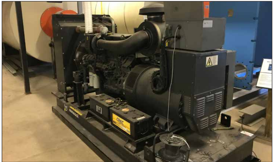
Photo : un groupe électrogène bien dimensionné et entretenu permet de surmonter la plupart des coupures de courant.
