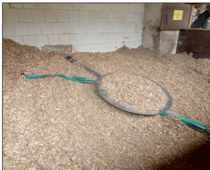
Photo 5 : Transfert par bras articulé (photo de l'entreprise döpiK Energietechnik GmbH, Stadtlöhn)
